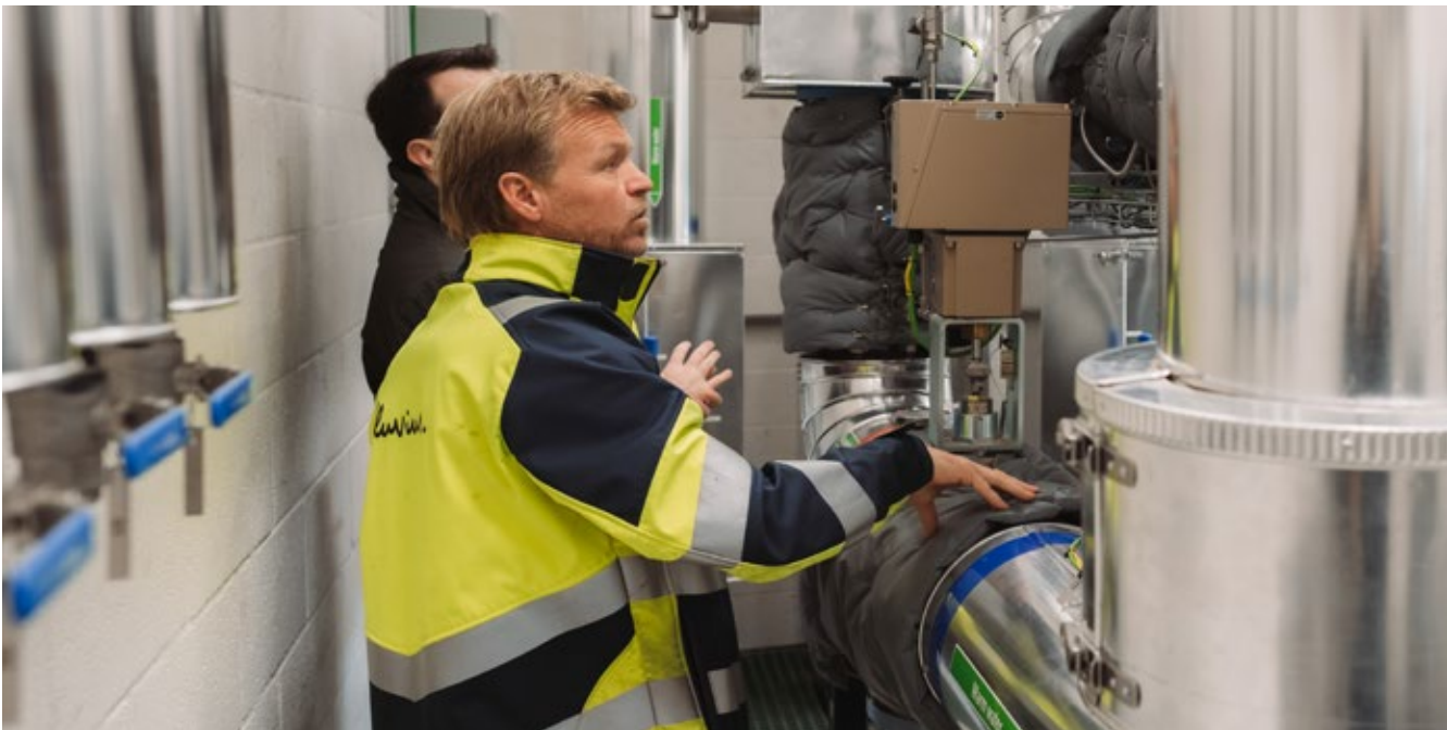
“Het warmteoverdrachtstation zet het water om naar een temperatuur van ongeveer 70 graden en een lagere druk, en verdeelt het daarna via de distributienetten naar de woningen.” © Fluvius
